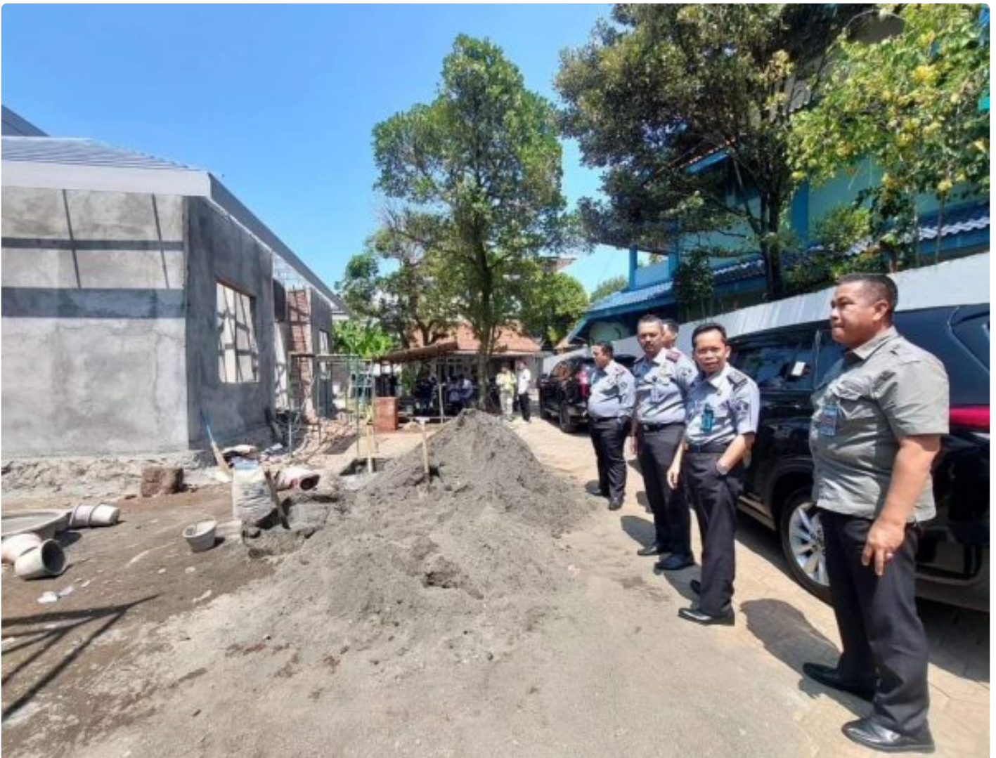
Kadivmin Kemenkumham Jateng Hajrianor Pantau Progres Pembangunan dan Renovasi Rumah Dinas Kanim Kelas I TPI Cilacap
